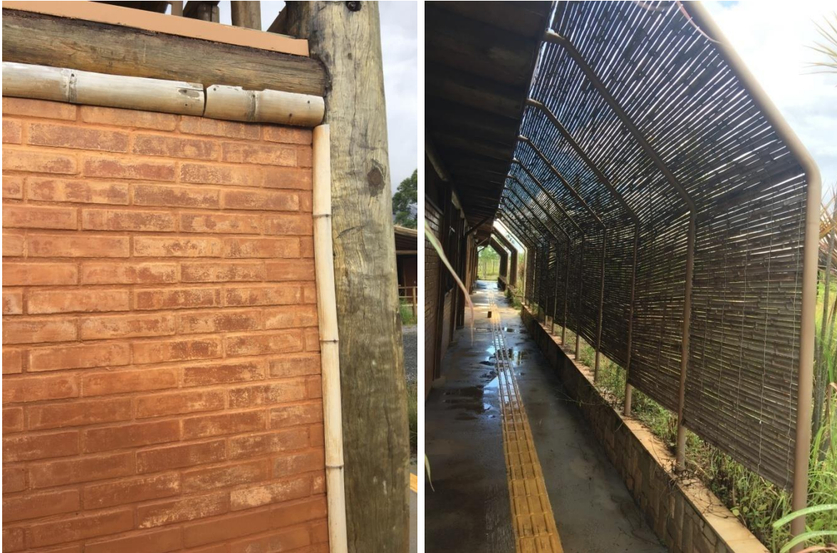
Figura 16: pavilhão de oficinas (detalhe) - estrutura em madeira e vedação em parede de tijolo solocimento bom estado de conservação e resistente ao tempo (acervo pessoal)
