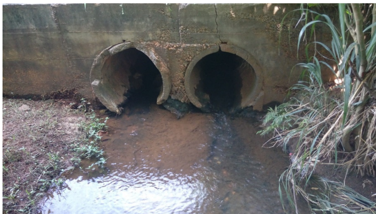
Figura 18. Lançamento de drenagem pluvial ao lado do IBAMA
