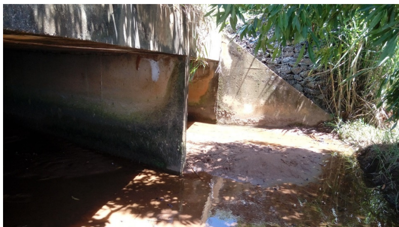
Figura 19. Galerias de seção retangular, lançamento próximo ao parque Olhos d'água
